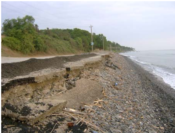
Рис. 5. Разрушение прибрежной зоны на северном побережье Азербайджана в результате подъема уровня моря
